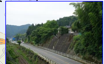
簗木国道横 崖上にブロック
