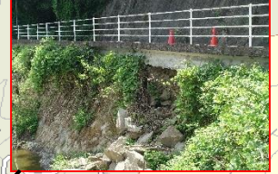
H30年7月の大雨で崩落
