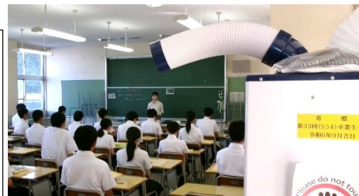
【美術室に設置したスポットエアコン】
