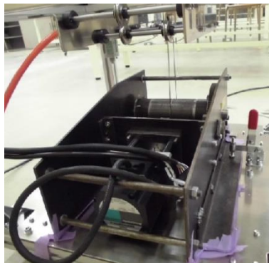
エレベータに設置
