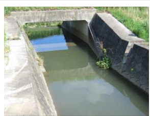
⑩ 浄水場東水路深み有
