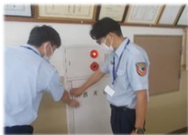
消防署より設備点検、指導
