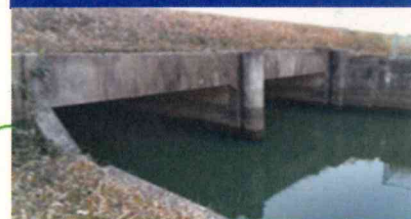
大きな段差 (例: 水門の水路)
