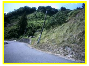
⑨崖崩れ危険
