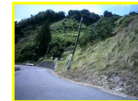
⑨崖崩れ危険
