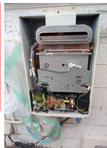
【給湯器の破損】
